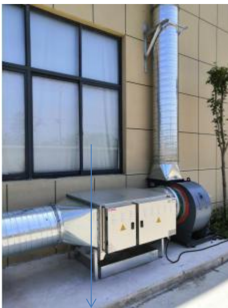
DTY 加弹废气排气筒（FQ-2）
